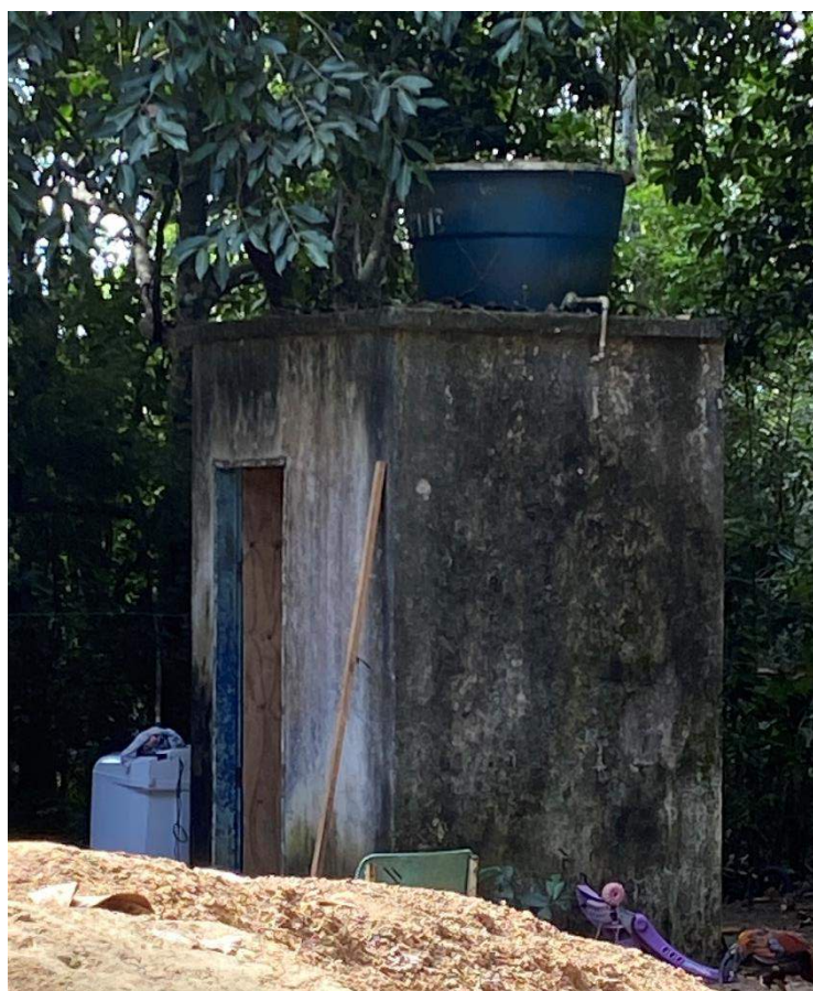
Figura 7-3: Condições dos banheiros, Aldeia Boa Esperança
