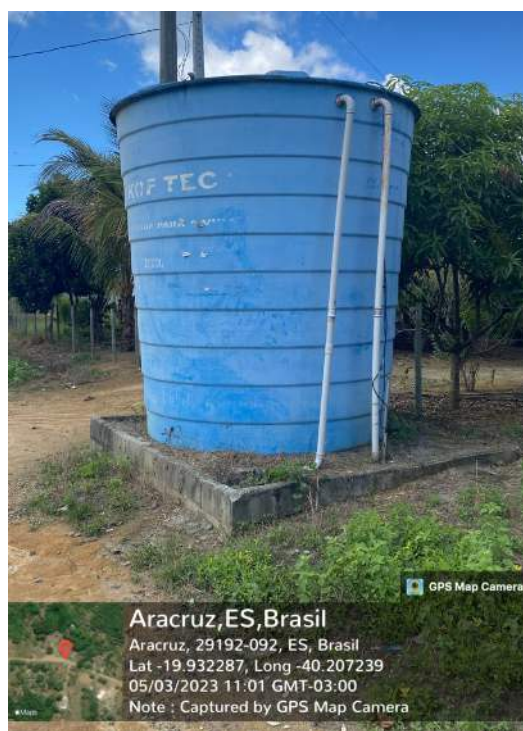
Figura 6-7: Reservatório apoiado da comunidade de Lajinha
