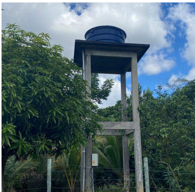
Figura 6-8: Reservatório elevado da comunidade de Lajinha
