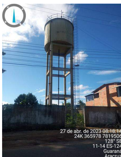
Figura 6-4: Reservatório da comunidade de Córrego D'água
